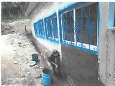
Foto 11: Cernido a pared de la parte trcera del aula
